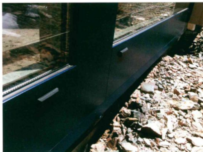
Typisches Schadensbild: Fenster-Festelement (RAL 7016) vor und nach der Reparatur.
